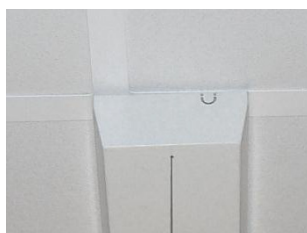
PASSE CÂBLE DANS LE SUPPORT PLAFOND
